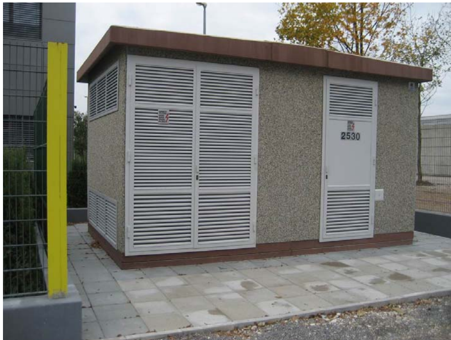
Slika 4. Samostojeća transformatorska stanica 1x2000 kVA
