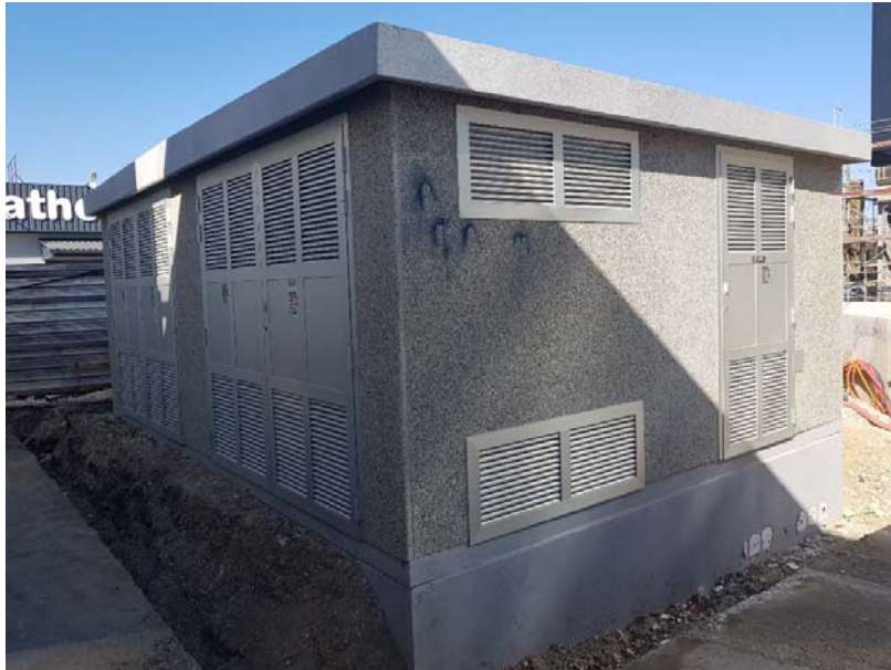
Slika 7. Samostojeća transformatorska stanica 2x2000 kVA
